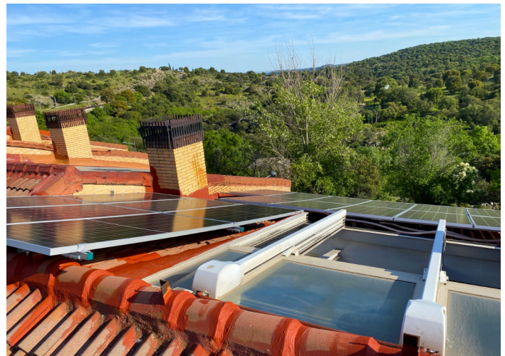
Die südliche Dachschräge besteht aus 20 Modulen, die ein großes Oberlicht und zwei große Schornsteine umgeben.
