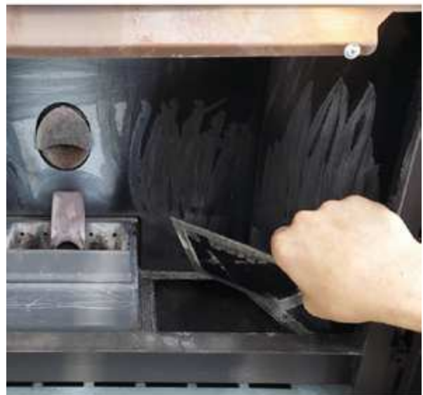
Fig. 25 - Den Inspektionsstopfen entfernen
