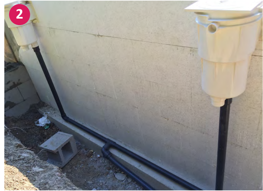
▲ Verrohrung von 2 Skimmer
