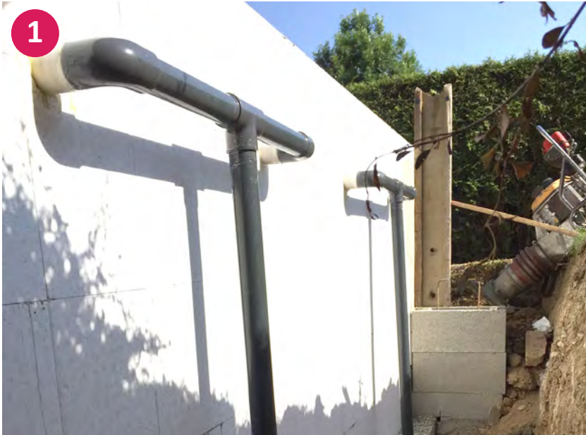
▲ Verrohrung von 4-Düsen
