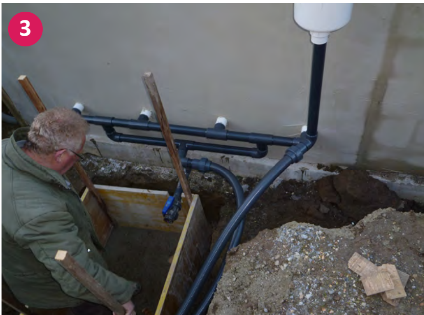
▲ Verrohrung von Düsen, Skimmer und Bodenablauf
