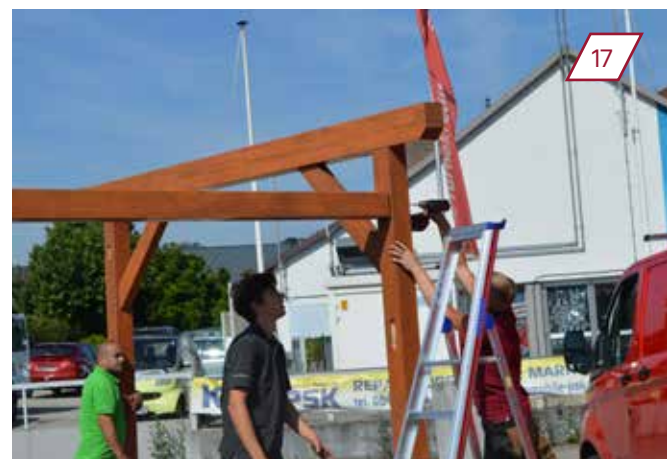
Pfosten mit Säulen verschrauben. Eventuell noch nicht komplett festschrauben, um vorab noch die Kopfbänder leichter anbringen zu können.
