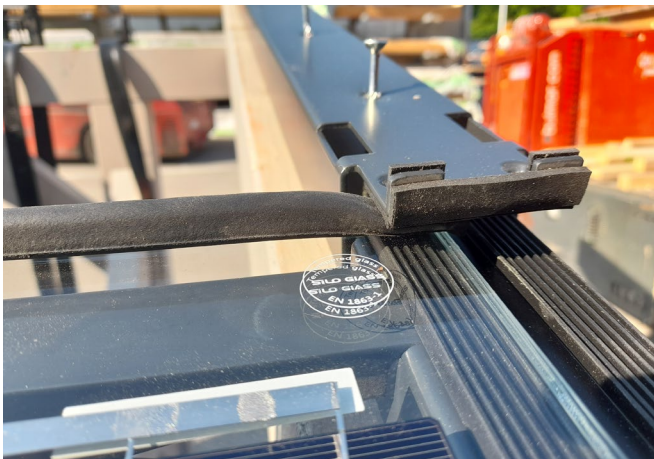
Keil liegt auf Glasdichtung auf.
