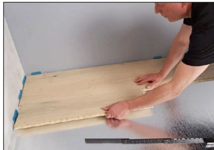
Die nächste Reihe wieder von links beginnen. Klicken Sie die Dielen einfach längsseitig zusammen. Eine Verleimung der Dielen ist nicht erforderlich.
