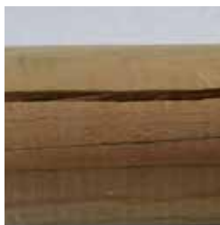
Cracks/Grietas/Fente/Risse/ Crepe/ Barsten/Fendas
